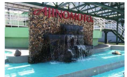
(上) ベトナム味の素社ビエンホア工場の排水処理設備 (下) 排水処理設備の隣に設置された「滝のモニュメント」
